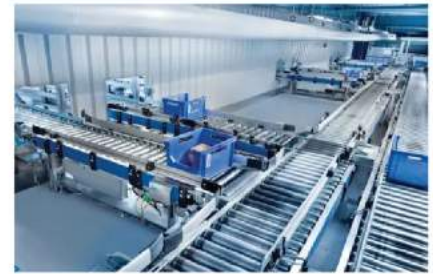
ระบบสายพานลำเลียง (Roller/Conveyer)
