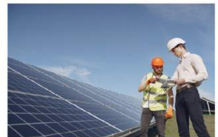
รับออกแบบ จำหน่าย ติดตั้ง Solar Cell (Solar Cell Solutions)
